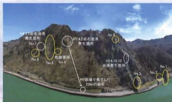
本尊岩・谷花地区の岩石崩落危険箇所
